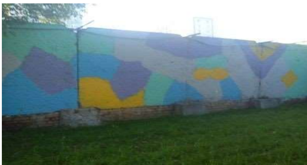
Рисунок 8 – часть окрашенного бетонного ограждения на территории интерната
