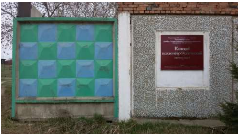
Рисунок 7 – часть окрашенного бетонного ограждения при входе на территорию интерната
