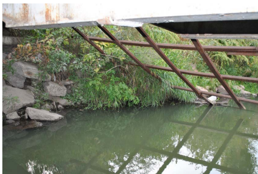
Рисунок 22- река Бугач, г. Красноярск, ул. Маерчака,
