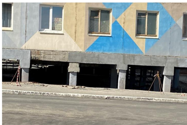
Рис. 2. Разрушение фундамента здания в Норильске (архив Т.А. Ананьевой)
