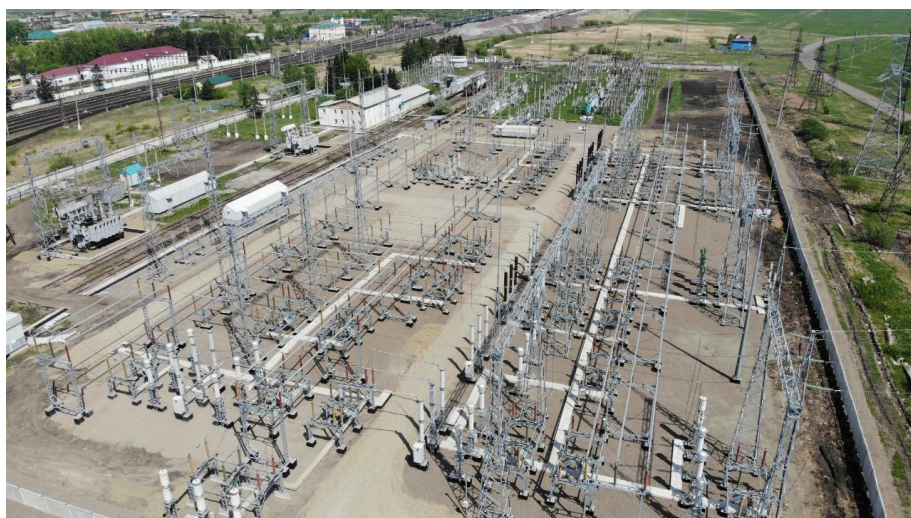
Рисунок 5 – Тяговая подстанция на станции Саянская
