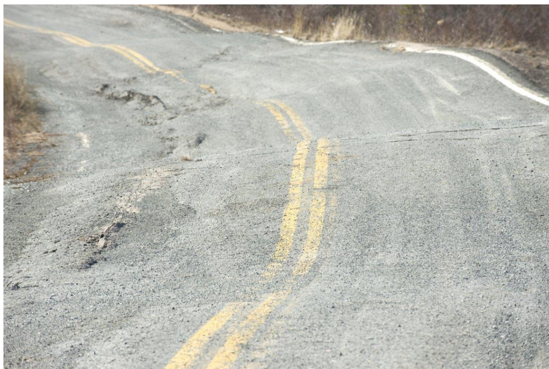
Рисунок 11 – Деформация автомобильной дороги в зоне вечной мерзлоты [19].
