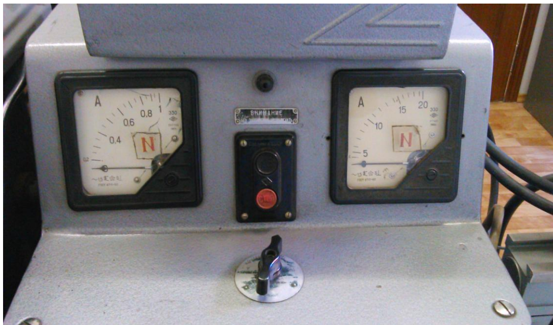
Рис.3 Внешний вид панели управления генератора ДГ-2
