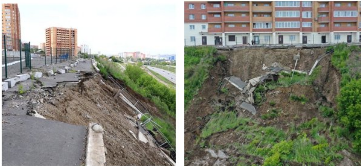
Рисунок 8,9. - Оползневые процессы на территории г. Красноярска.
