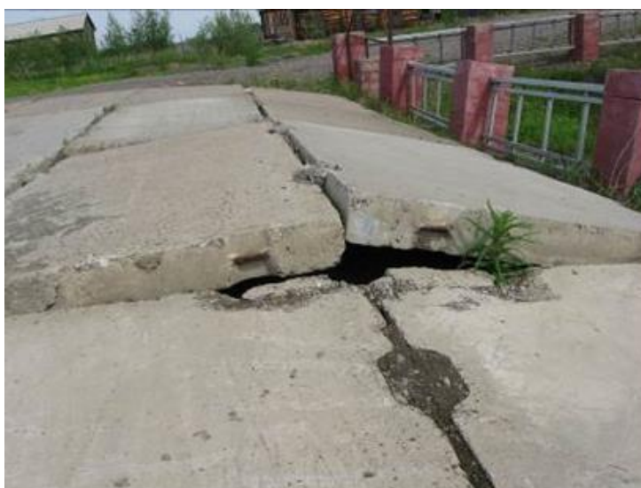
Рис.3. Пучение дорожного полотна в районе музея многолетней мерзлоты в г. Игарке [25].
